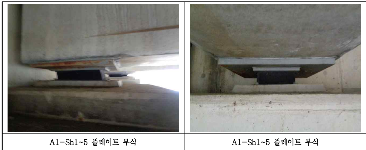
【사진 14.3.36】 교량받침 손상현황
