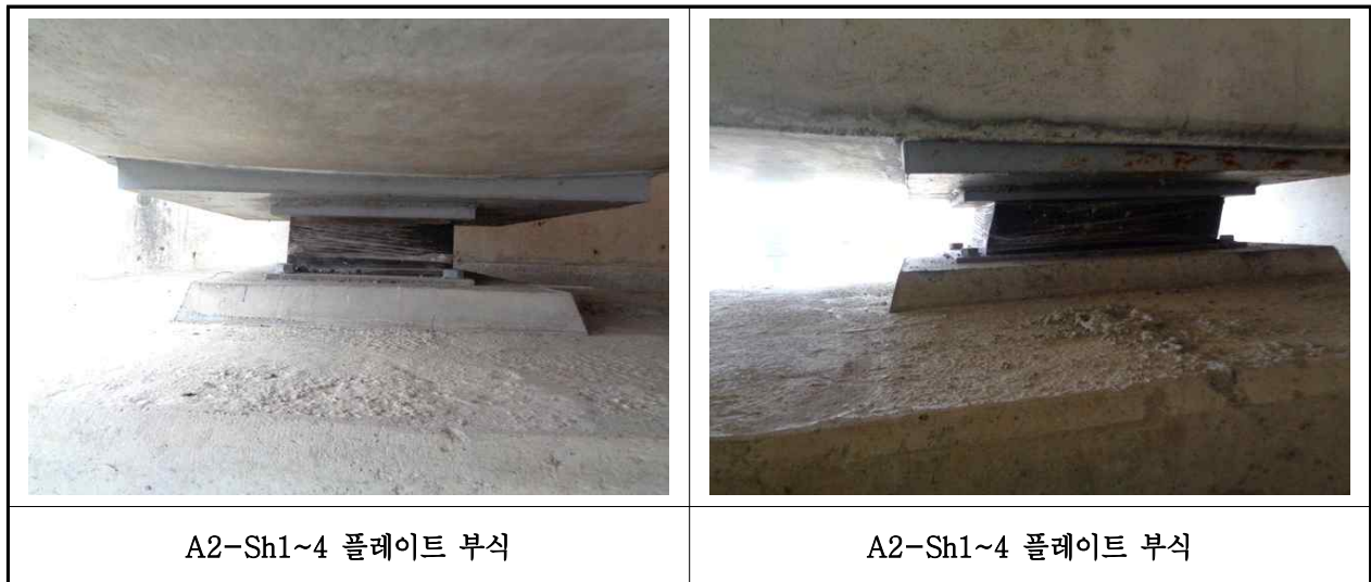
【사진 14.3.13】교량받침 손상현황
