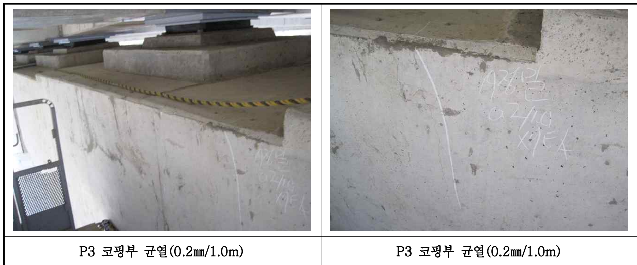
【사진 14.3.34】 교각 손상현황
