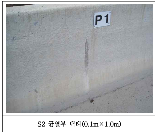
【사진 14.3.47】 방호벽 손상현황
