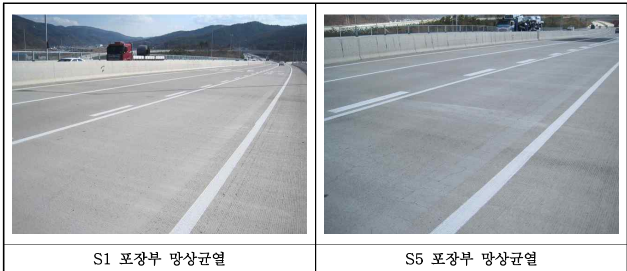
【사진 14.3.43】 교면포장 손상현황
